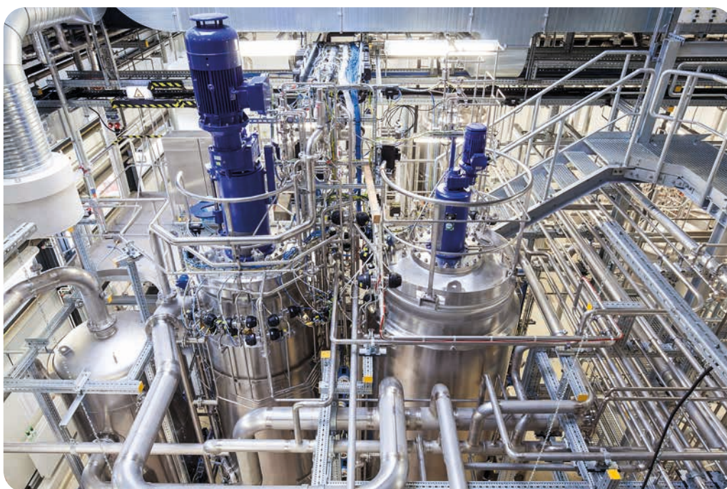
Démonstrateur industriel de Global Bioenergies installé à Leuna
